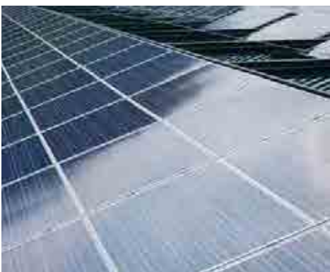
Photovoltaik als wichtiger Bestandteil der Energieversorgung.
